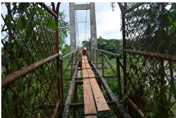
Ponte pênsil em Tubarão está em reforma (Foto: Divulgação/Prefeitura de Tubarão)
